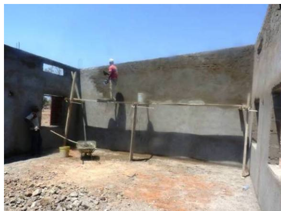
Enduit des salles de classes
