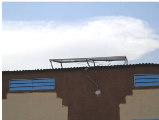
Panneau solaire sur le toit de l'école
