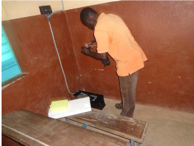
Installation de la batterie et du régulateur
