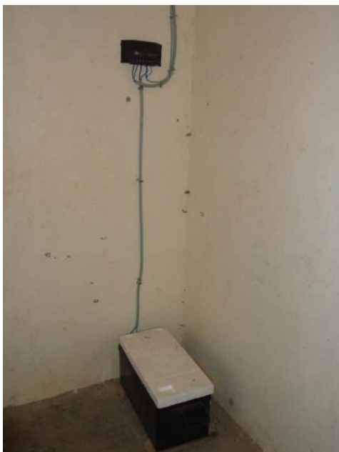
Batterie et régulateur à l'intérieur d'une salle de classe de Wodougou
