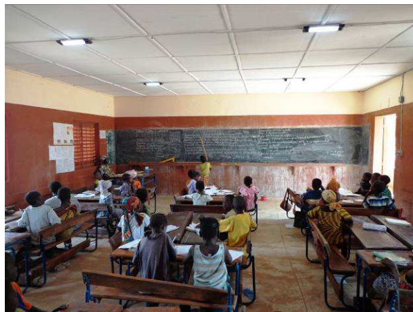
Lampes intérieures dans une salle de classe de Blengoua
