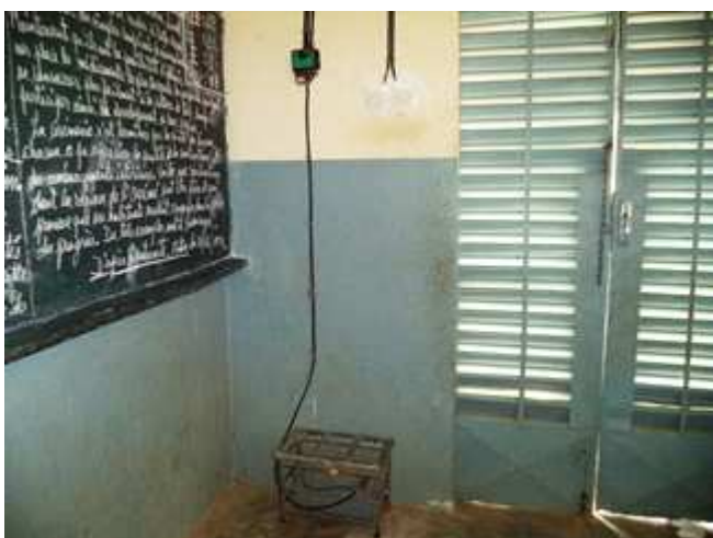
Batterie et régulateur à l'intérieur d'une salle de classe de Gonido
