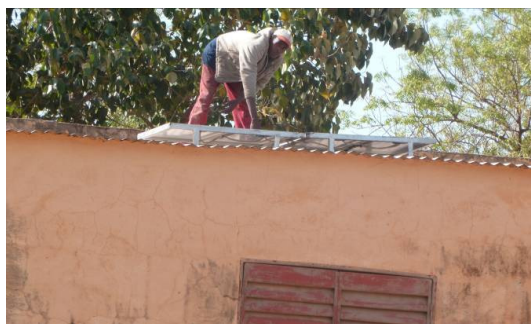
Un membre du comité de gestion à côté des panneaux nouvellement installés
