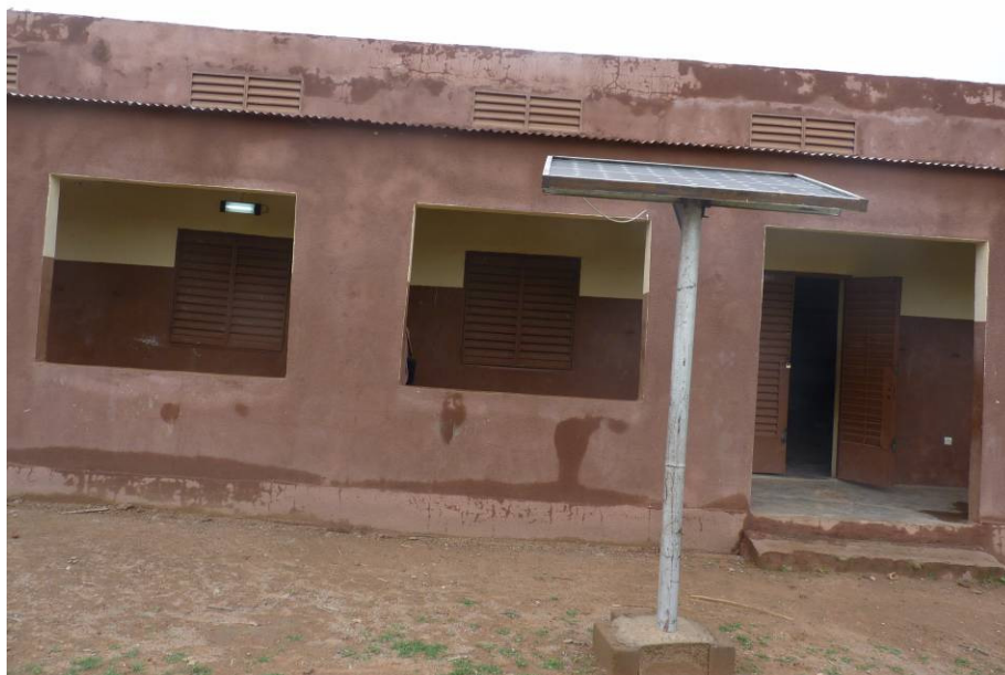
Un des deux panneaux solaires installés dans la cour de l'école de Missango
