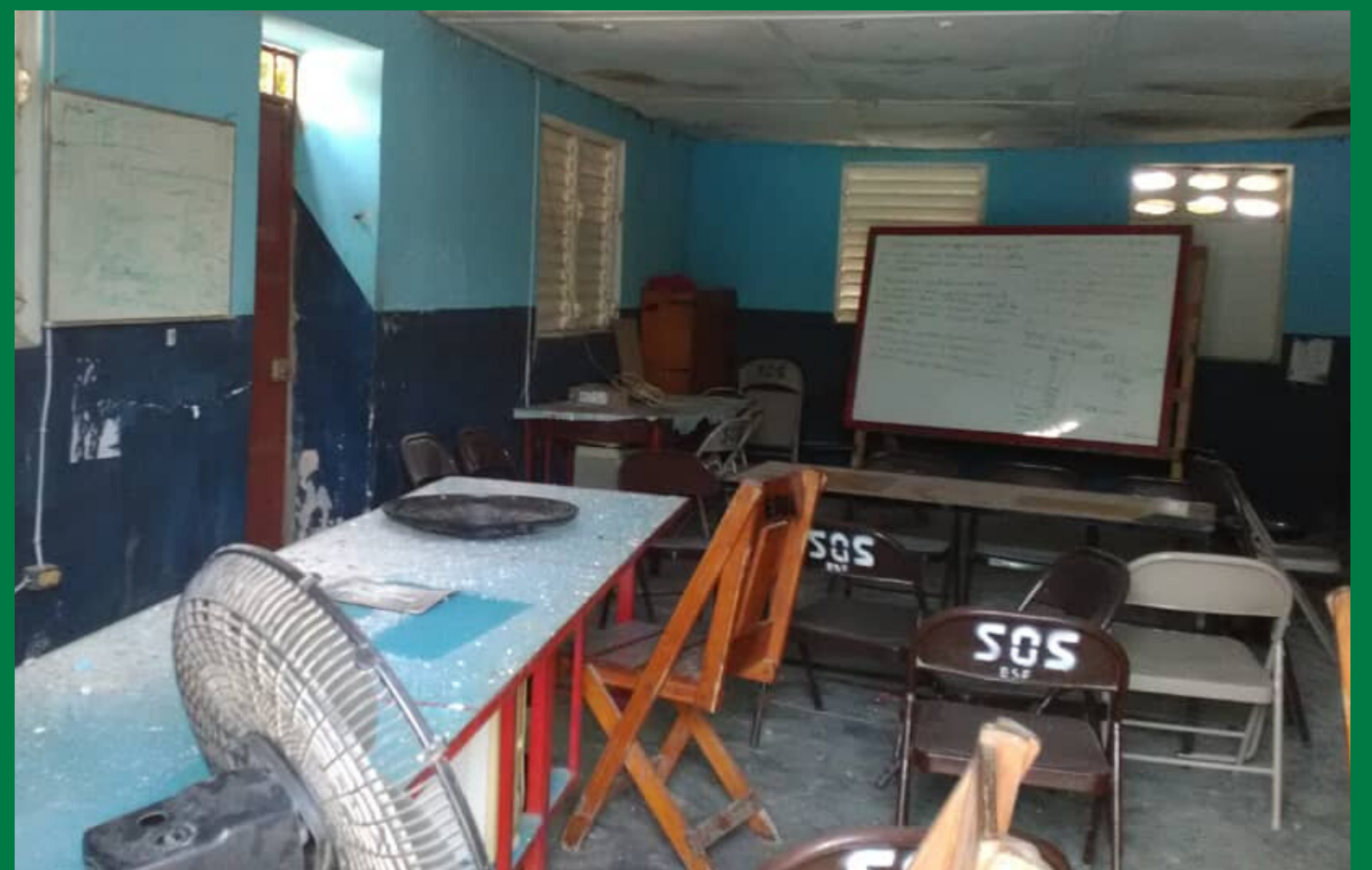
Etendue des dégâts à l'intérieur de la salle informatique, rendue inutilisable
