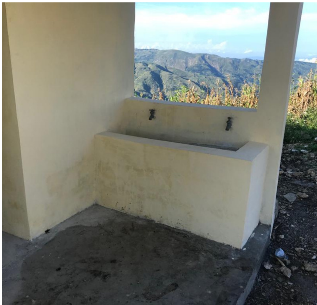
Lave-main collectif à l'entrée du bloc
