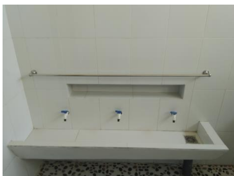
Des lavabos ont été installés dans chaque pièce afin que les enfants puissent se laver les mains
