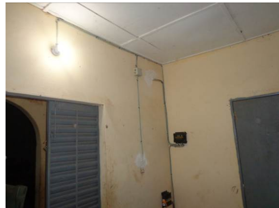
Le régulateur installé dans une des pièces de l'école de 2 ème cycle
