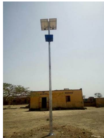
Le lampadaire en pleine recharge !
