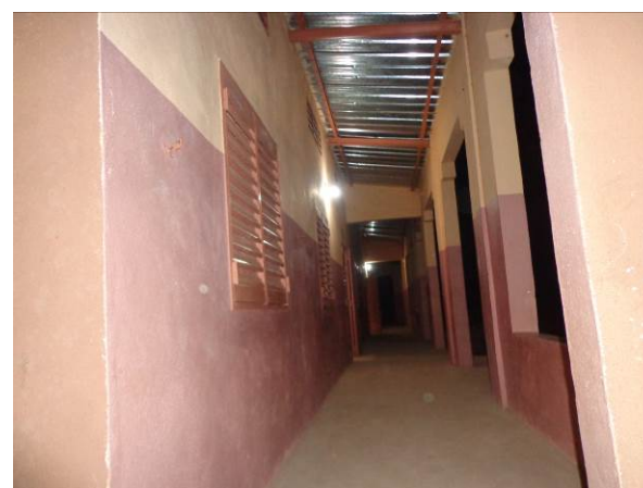
Couloir de l'école du 1 er cycle est électrifié
