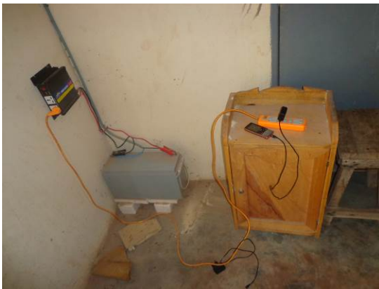
La batterie et le système de prise qui permet de recharger les portables
