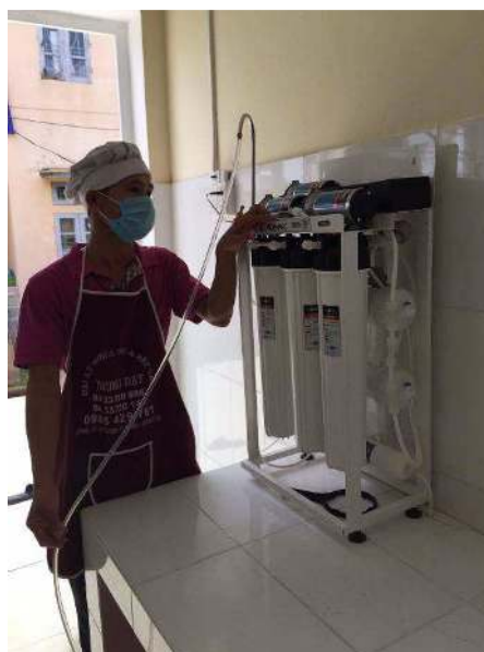
Système de filtration de l'eau pour un accès à l'eau potable dans l'école.
